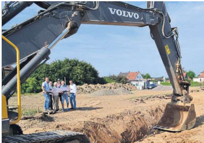
Der Bagger leistet bereits ganze Arbeit: Lokaltermin in der Schottener Straße mit Vertretern der Stadt, der Baufrirma und des Ingenieurbüros. (Foto: tb)
