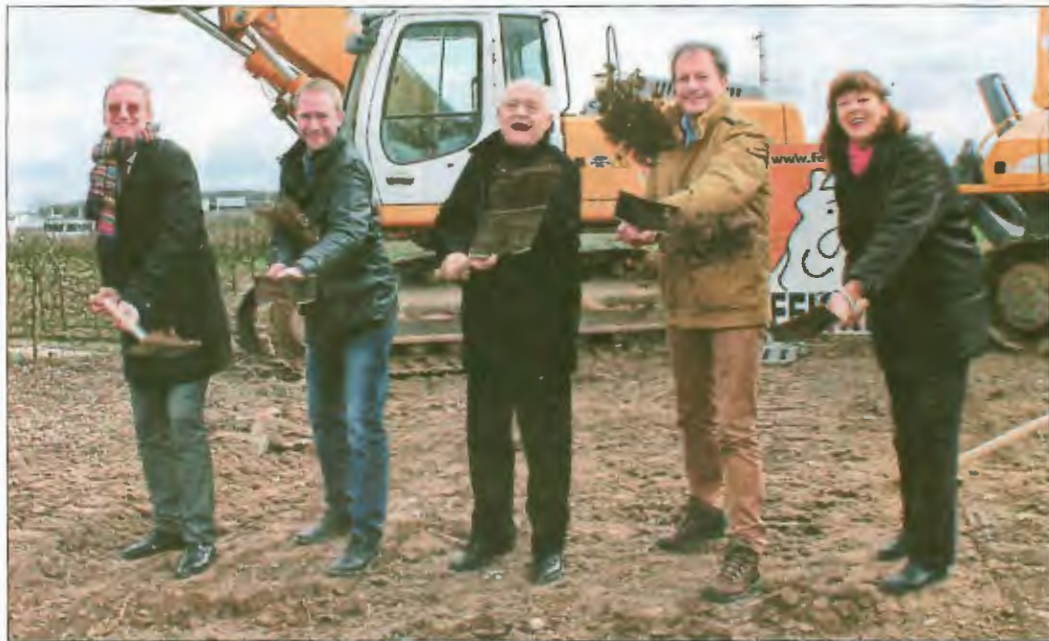
Die Spaten im Baugebiet »Sang« schwingen am Mittwoch (v. l.): Die Ingenieure Otfried Heineck und Ragnar Feickert, Altbürgermeister Detlef Brechtel, Rathauschef Thomas Alber und die Stadtverordnetenvorsteherin Regina Kahrenke. (Foto: lk)
