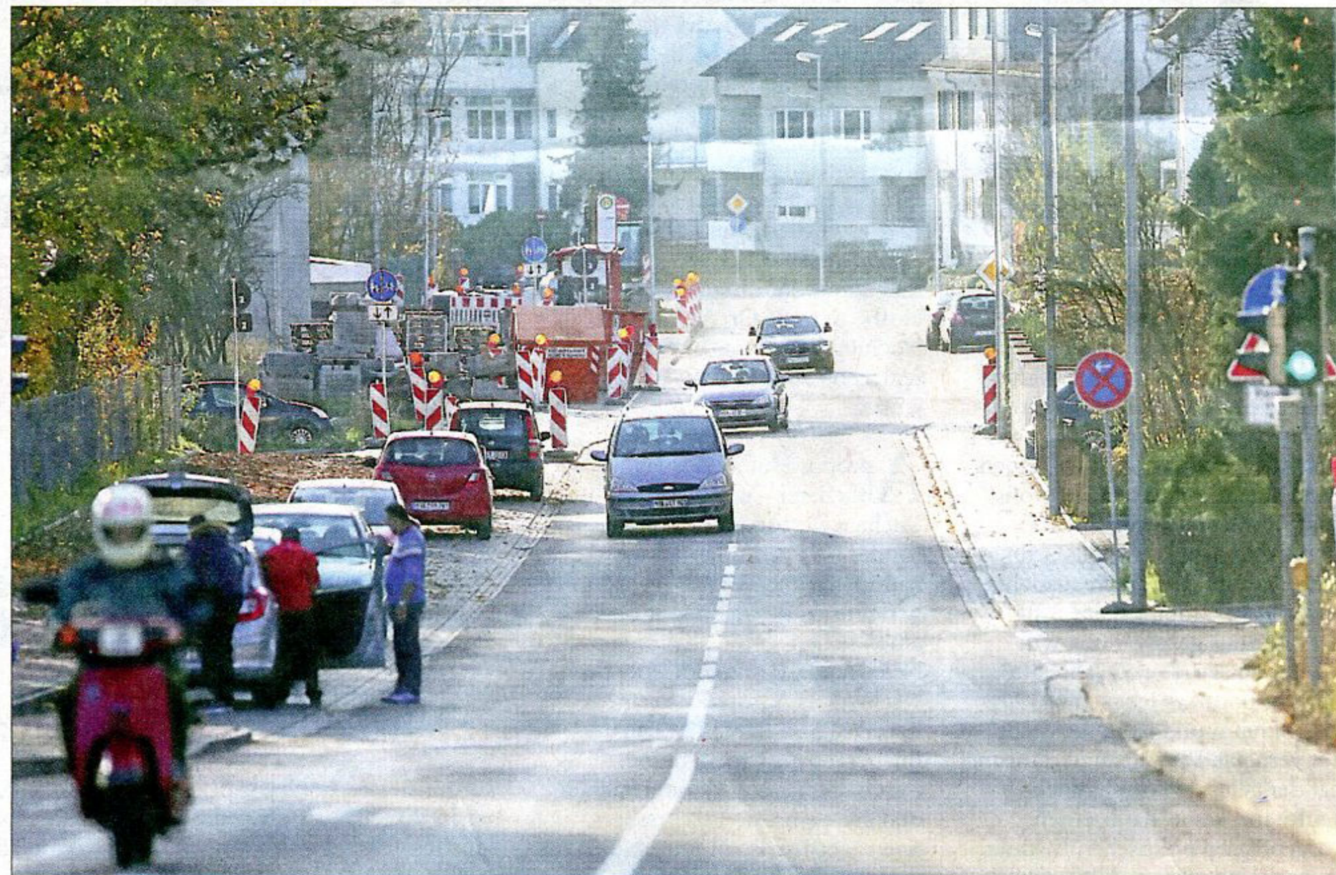
Seit gestern Nachmittag kann der Schmelzweg wieder befahren werden. Es gibt nur noch Restarbeiten.
