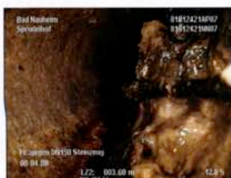
Problemfall: Von mineralischen Inkrustationen verstopftes Abwasserrohr vor ...
