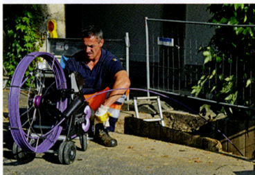
Noch während der Sanierungsarbeiten mussten immer wieder neu entdeckte Leitungen geortet und per TV-Kamera untersucht werden.
