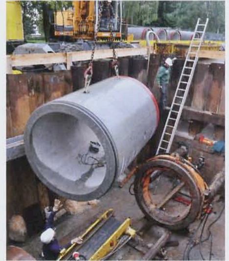
Sieben Tonnen im Schwebezustand: Einbau von einem der sechs Stahlbetonrohre, die unter der Vogelsberg-Bahn hindurch gepresst wurden.
